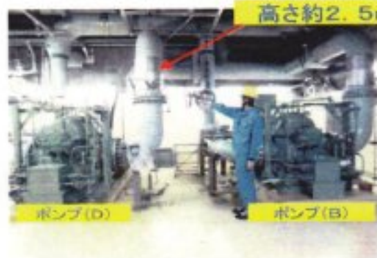
原子炉補機冷却水B系ポンプ室
