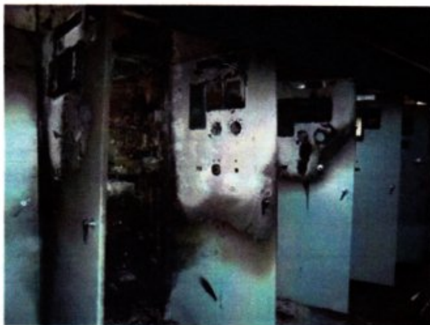
高圧電源盤 現場写真
