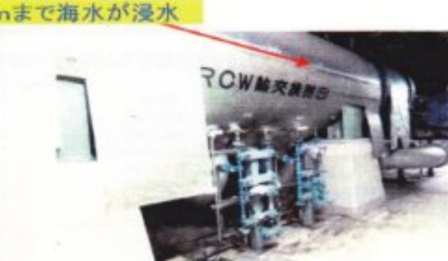
原子炉補機冷却水B系熱交換器室
