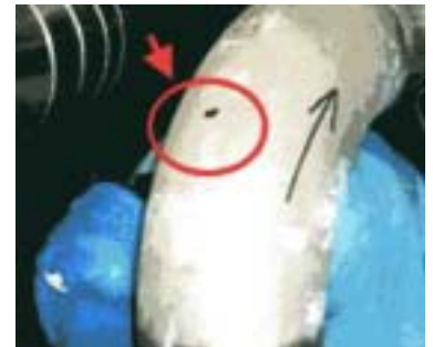
(写真は東北電力のホームページから。配管口径約170ミリ、材質はステンレス鋼)
